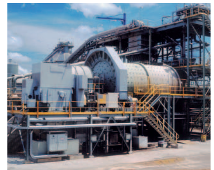
Lagerungen in Zerkleinerungs- und Aufbereitungsanlagen
